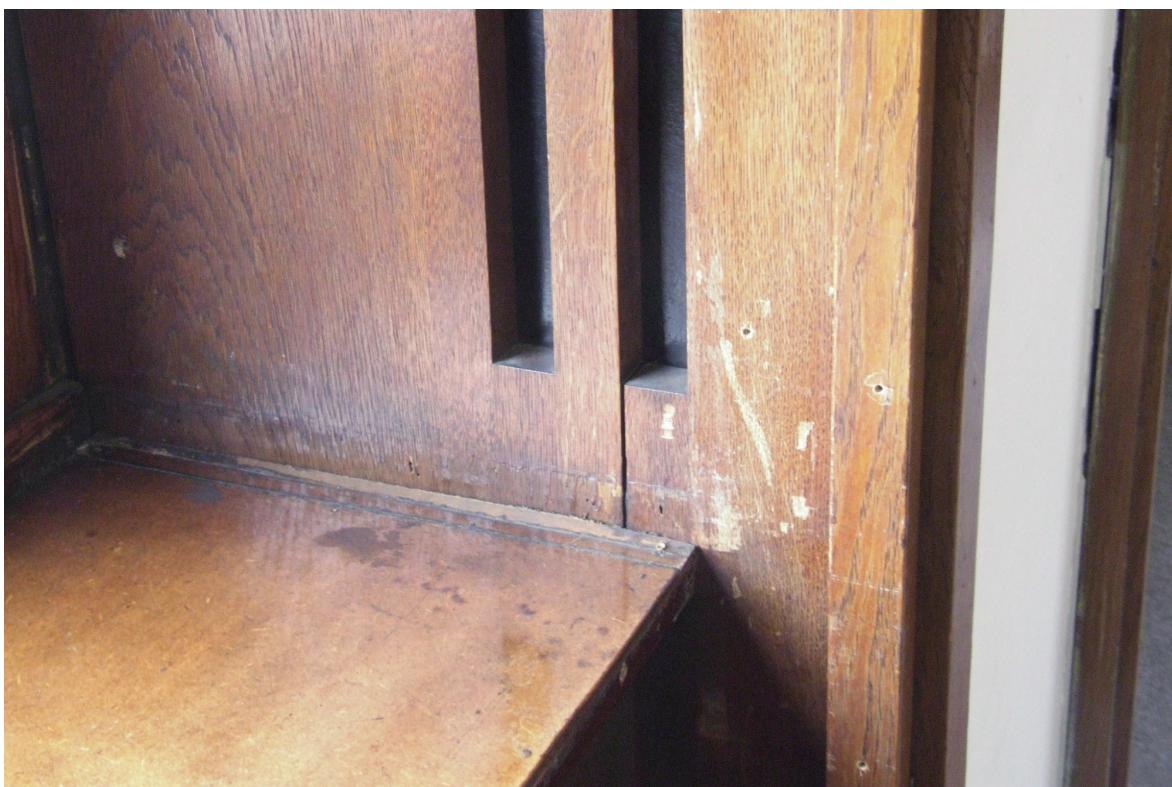
Snímek 17: Okenní obložení a parapet (2. okno) – před restaurováním
