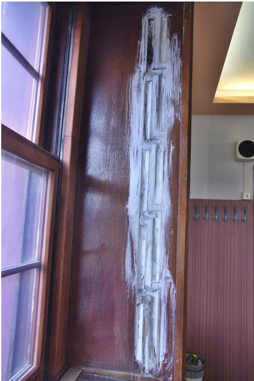
Snímek 11: Bok okenního obložení (1. okno) – před restaurováním
