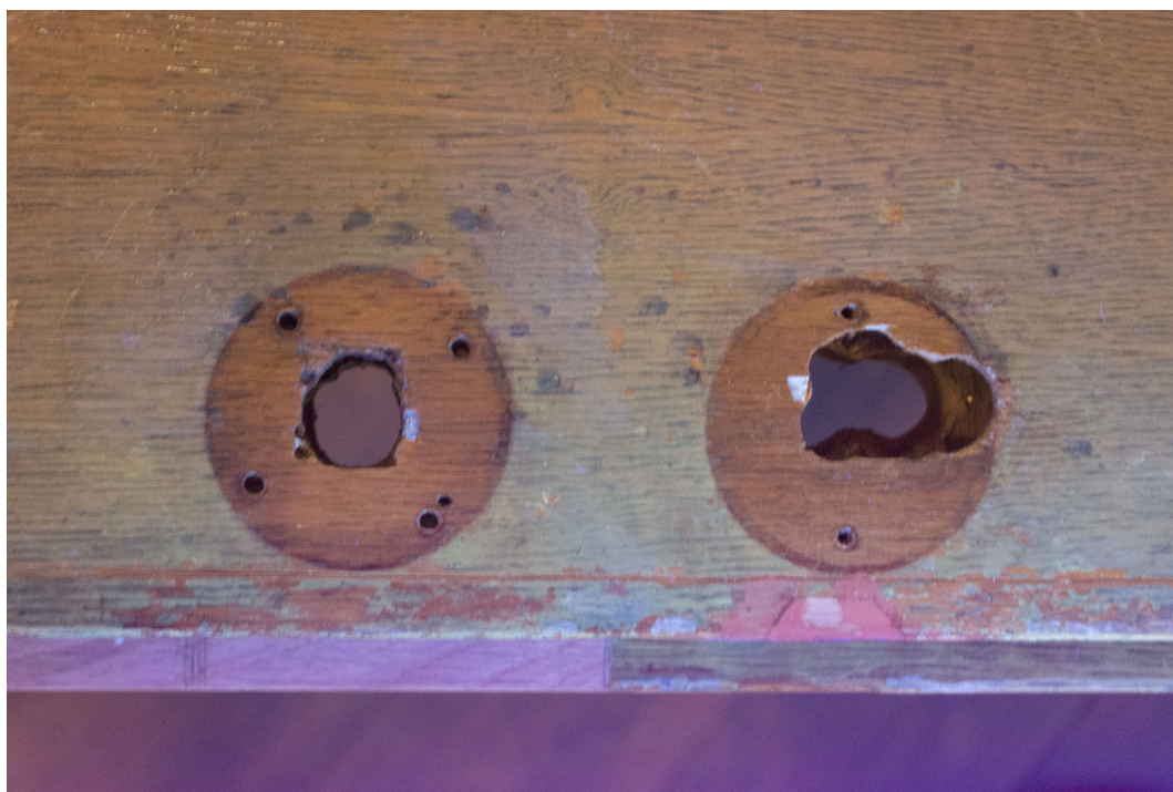
Fig. 3.1: Detail dveří po sejmutí kování, pod UV
