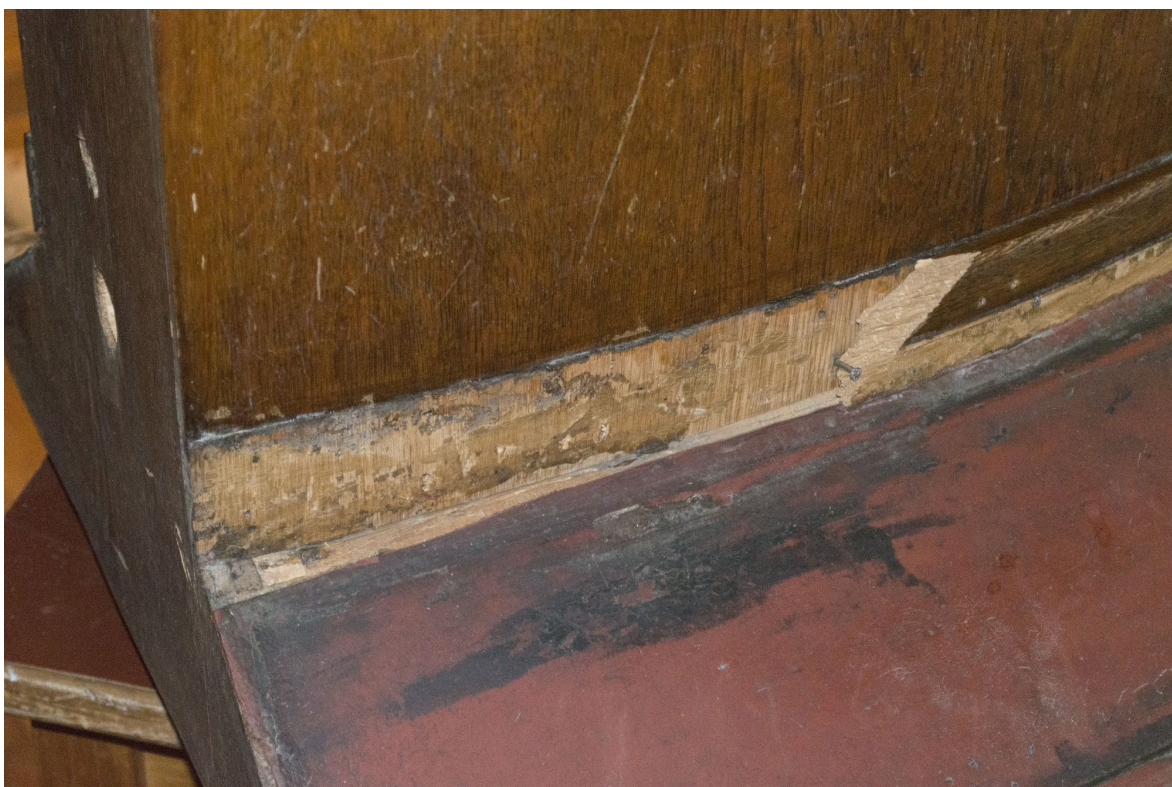
Snímek 53: Detail poškození podstavce – před restaurováním
